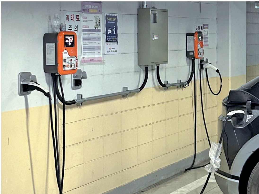
서울캠 오비스홀 지하주차장에 위치한 전기차 충전소
