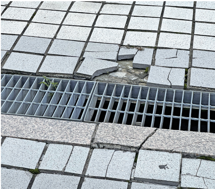
잦은 오토바이 출입으로 깨진 사색의 광장 타일
