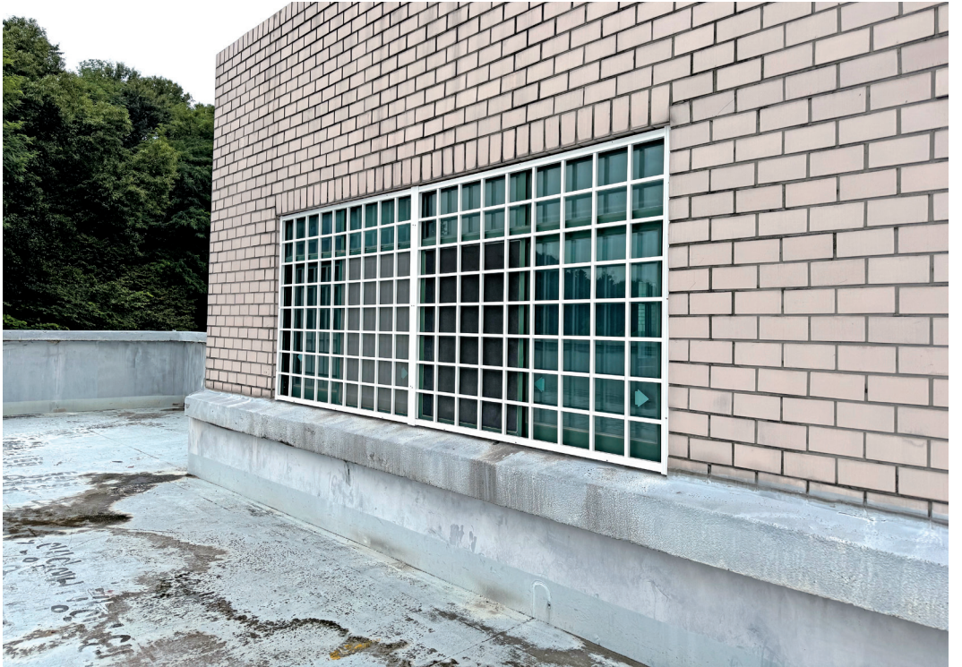
옥상 출입문 옆 창문에 설치된 방범창
